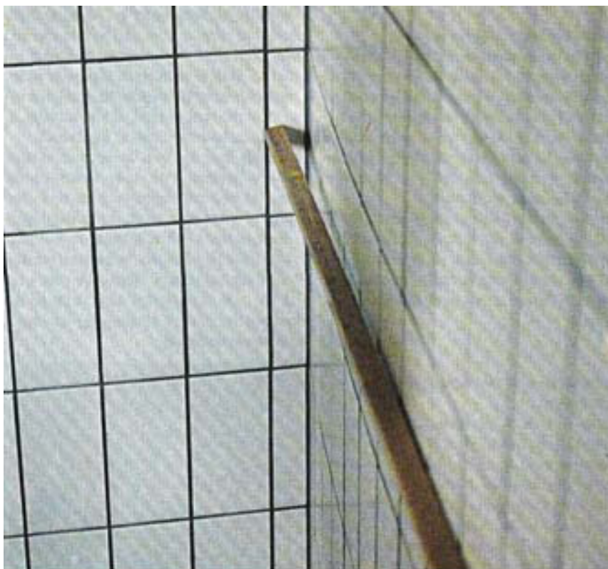
Fig. 1. Retholdt på udbøjet flisebeklædt spånpladevæg. Fugtbevægelser i spånpladerne bag de keramiske fliser forårsager uacceptabelt store udbøjninger.
